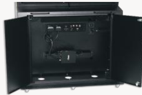
Lockable Cabinet with Screen AV Inputs and Audio Faceplate.
